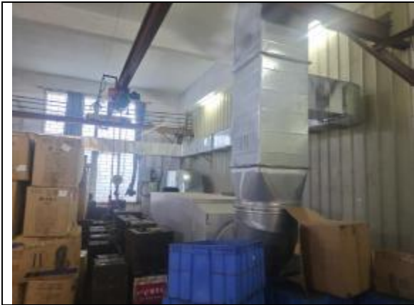
活性炭装置及排气筒
